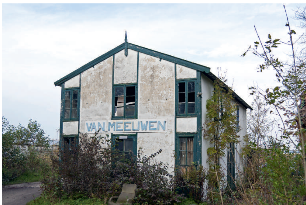
▲ De authentieke bollenschuur aan de Manpadslaan in 2011. Nu zijn de raamopeningen dichtgetimmerd.
