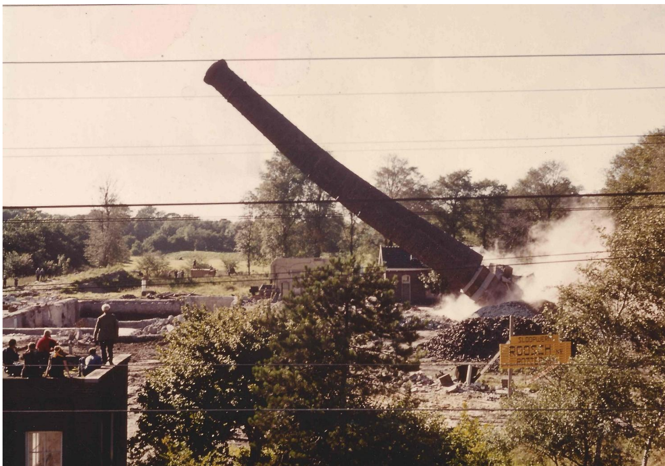
Omhalen van de 40 meter hoge schoorsteen van het tweede pompstation, na 1954 (collectie Pierre Geelen).
